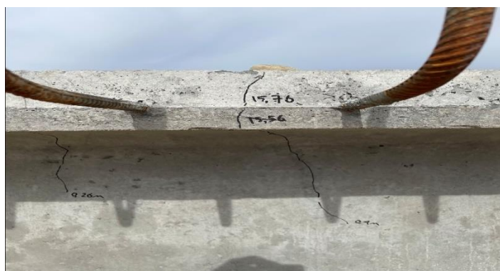
Рисунок 9 – Трещина в плите проезжей части и в ребре балки ВТК-33у на расстоянии 15,76м от ее торца (с одной стороны балки)
