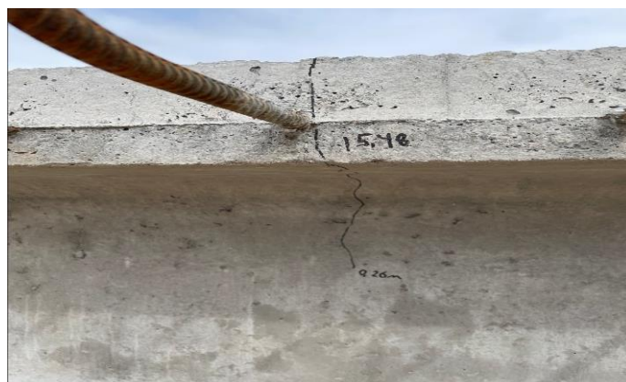
Рисунок 7 – Трещина в плите проезжей части и в ребре балки ВТК-33у на расстоянии 15,48м от ее торца (с одной стороны балки)
