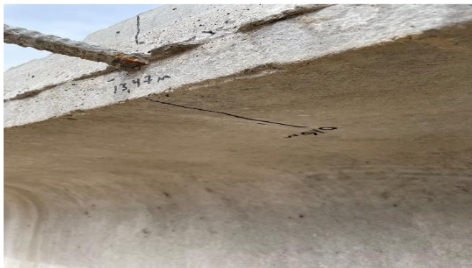
Рисунок 3 – Трещина в плите проезжей части балки ВТК-33у на расстоянии 13,47м от ее торца (с одной стороны балки)
