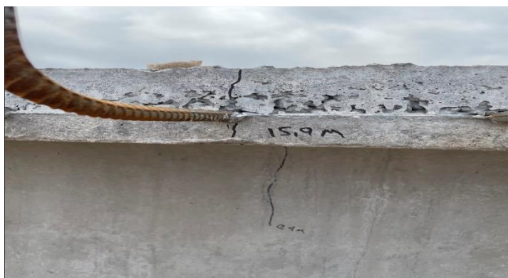
Рисунок 10 – Трещина в плите проезжей части и в ребре балки ВТК-33у на расстоянии 15,9м от ее торца (с другой стороны балки)
