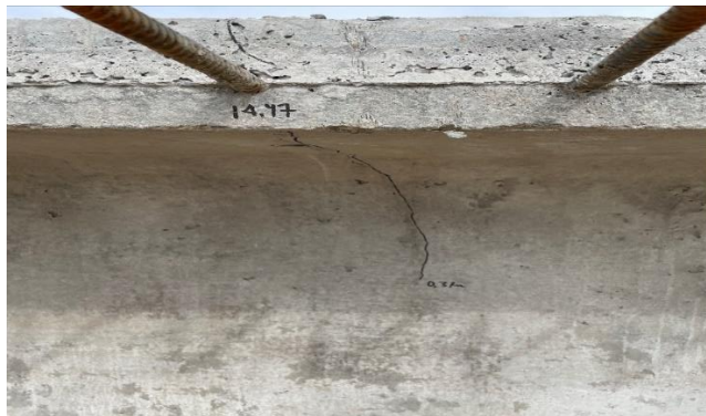
Рисунок 5 – Трещина в плите проезжей части и в ребре балки ВТК-33у на расстоянии 14,47м от ее торца (с одной стороны балки)
