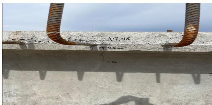
Рисунок 11 – Трещина в плите проезжей части и в ребре балки ВТК-33у на расстоянии 17,46м от ее торца (с одной стороны балки)
