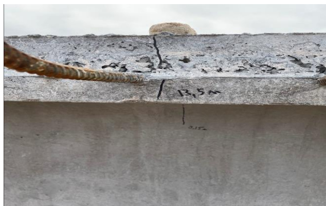
Рисунок 4 – Трещина в плите проезжей части и в ребре балки ВТК-33у на расстоянии 13,5м от ее торца (с другой стороны балки)
