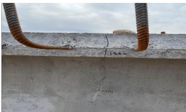
Рисунок 6 – Трещина в плите проезжей части и в ребре балки ВТК-33у на расстоянии 14,6м от ее торца (с другой стороны балки)
