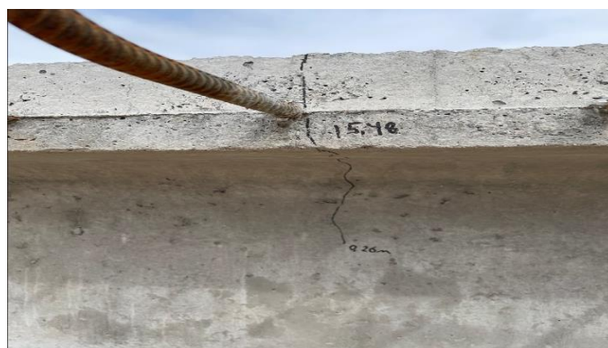
Рисунок 8 – Трещина в плите проезжей части и в ребре балки ВТК-33у на расстоянии 15,48м от ее торца (с одной стороны балки)
